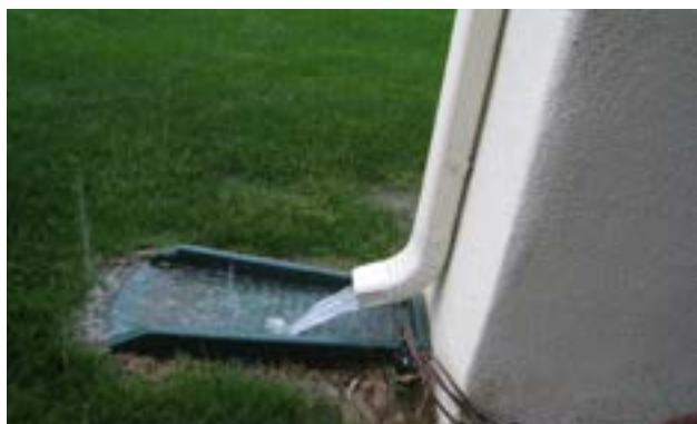
Figura 75. Bajante en Scottsdale (Estados Unidos) en la que la escorrentía es dirigida a una zona verde. Fuente: Bloomfield, 2009.
