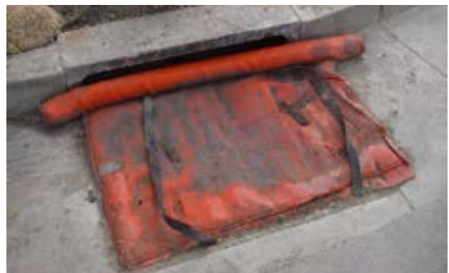
Figura 14. Protección de sumidero de aguas lluvias contra sedimentación y material particulado de obra. Fuente: https://www.lakecountynyohio.gov/portals/21/inlet_protection.jpg
