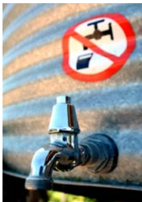
Figura 19. Ejemplo de grifería, sin llave accesible a público general y señal de aviso de agua no potable para usos distintos al consumo humano. La llave de apertura solo esta en posesión y manipulación del personal de mantenimiento.
