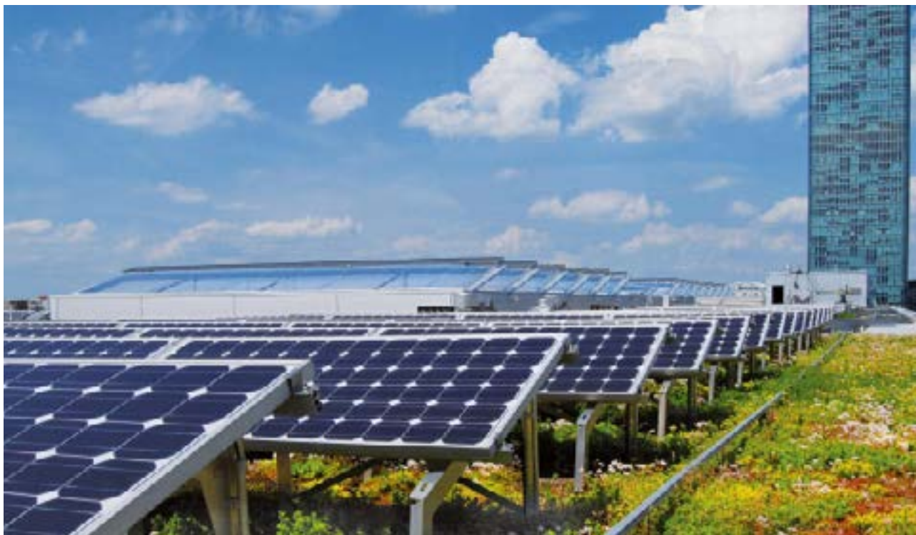
Figura 9. Cubierta con paneles solares. Fuente: Green Roof & Solar System | ZinCo Canada, s. f.
